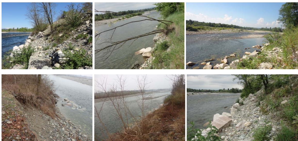
Difese spondali ammalorate in corrispondenza del tratto di intervento
